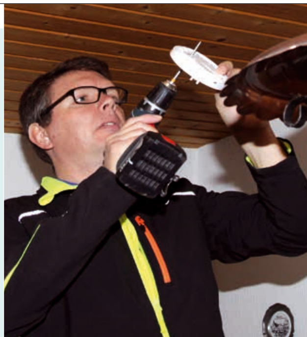
Zum Schutz der Mieter, vom Experten installiert: Elektromeister Wolfgang Baumgartner beim fachmännischen Anbringen eines Rauchmelders in einer Wohnung der Stadtbau GmbH Dachau.
