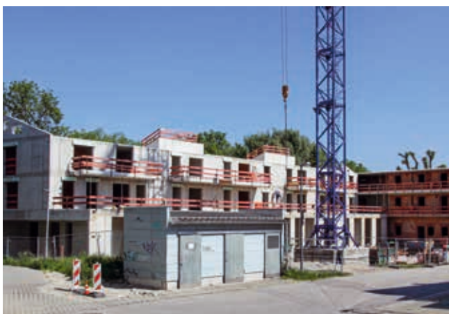
Unten Kindertagesstätte, oben günstige Mietwohnungen: Die Baustelle der Stadtbau Dachau am Amperweg.
