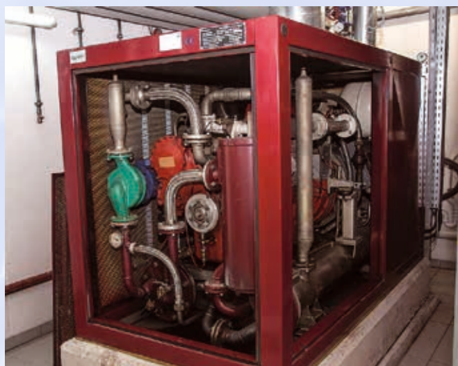
Blockheizkraftwerk in einer Wohnanlage
